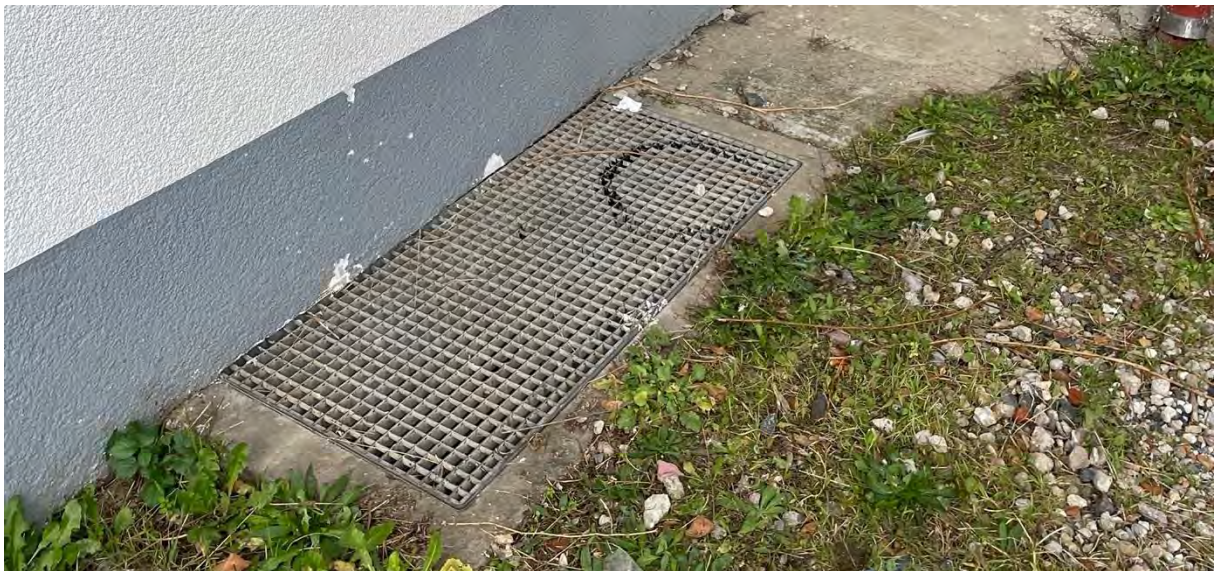
Abb. 38: Ungeschützter Lichtschacht an der Ostseite des Verwaltungsgebäudes
